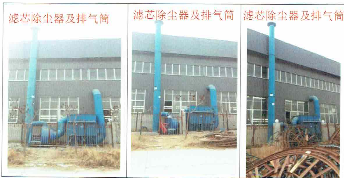
图 3-1 滤芯除尘器及排气筒现场照片
